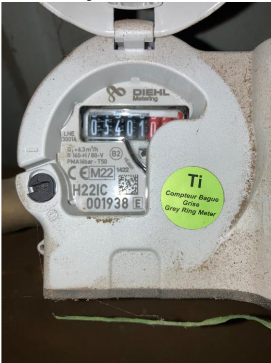
Vue sur le compteur du forage existant
